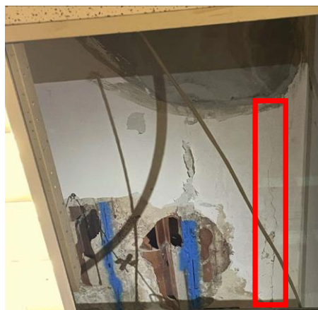
Figura 9 – Fessura longitudinale travetto (in rosso)
